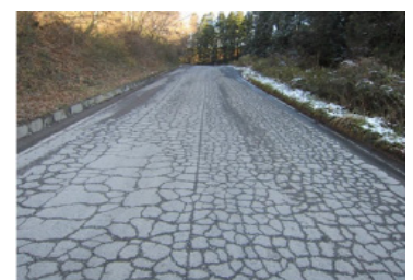
(損壊した道路の状況)
